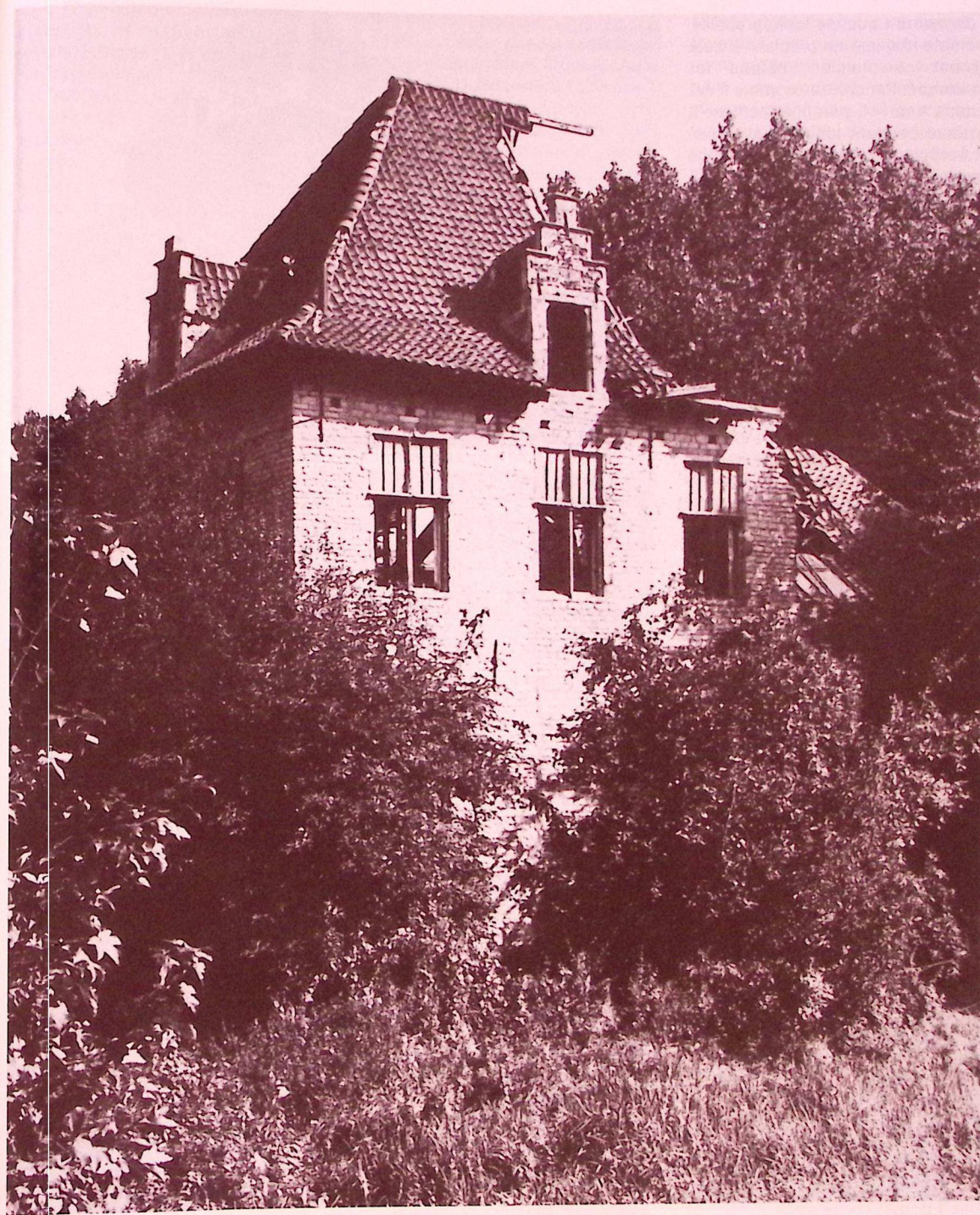
Le Slot en 1984. Son état de délabrement confinant à la ruine impose des mesures urgentes de restauration et de consolidation si l'on veut éviter qu'il ne soit perdu à jamais.
